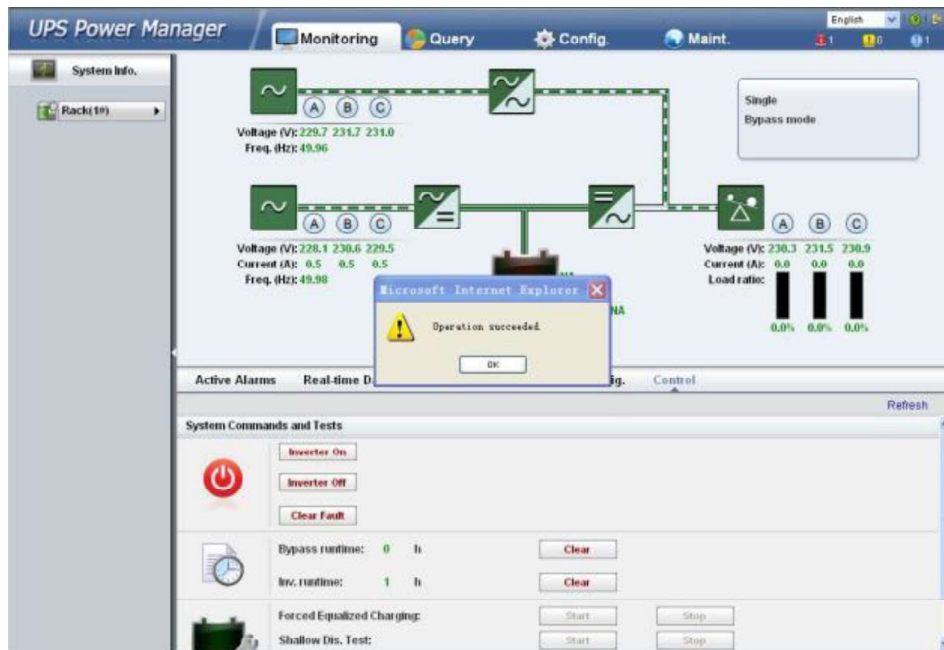
Abbildung 5-21 Den Alarm auf der WebUI löschen
